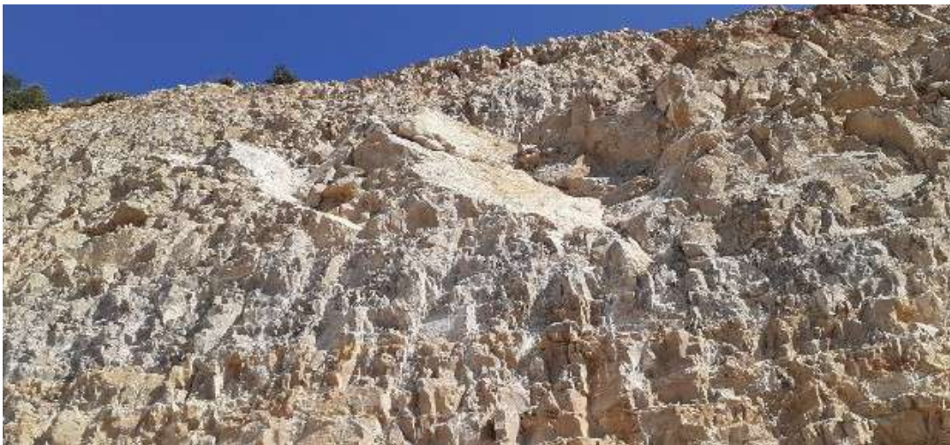
Figura 4-9 Rrëshqitje në formë pykë në ByPass Vlora km 14+100
