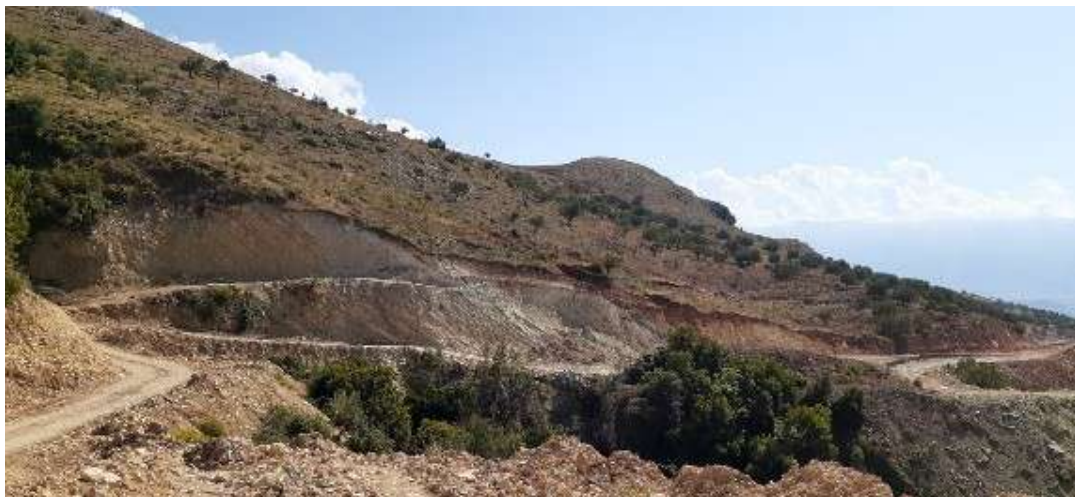
Figura 4-7 Rrëshqitje Planare në ByPass Vlora km 17+350
