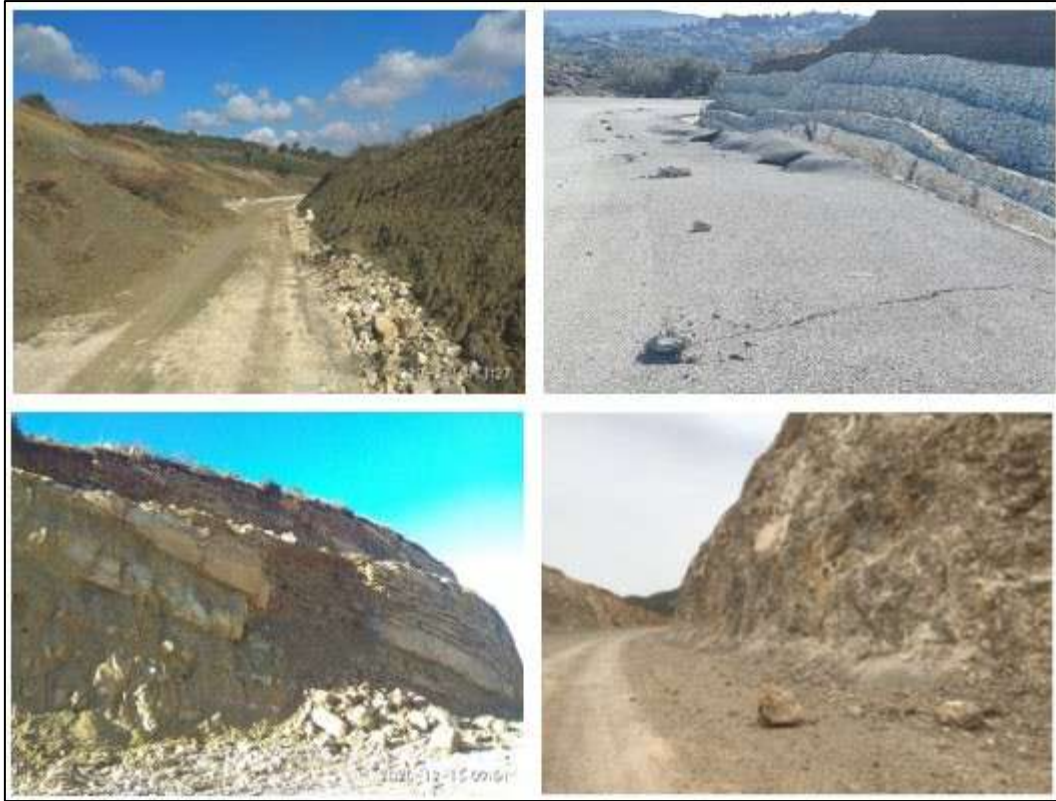
Figura 5-10 Evidentimi i disa fenomeneve gjeologjike ne Bypass Vlora
