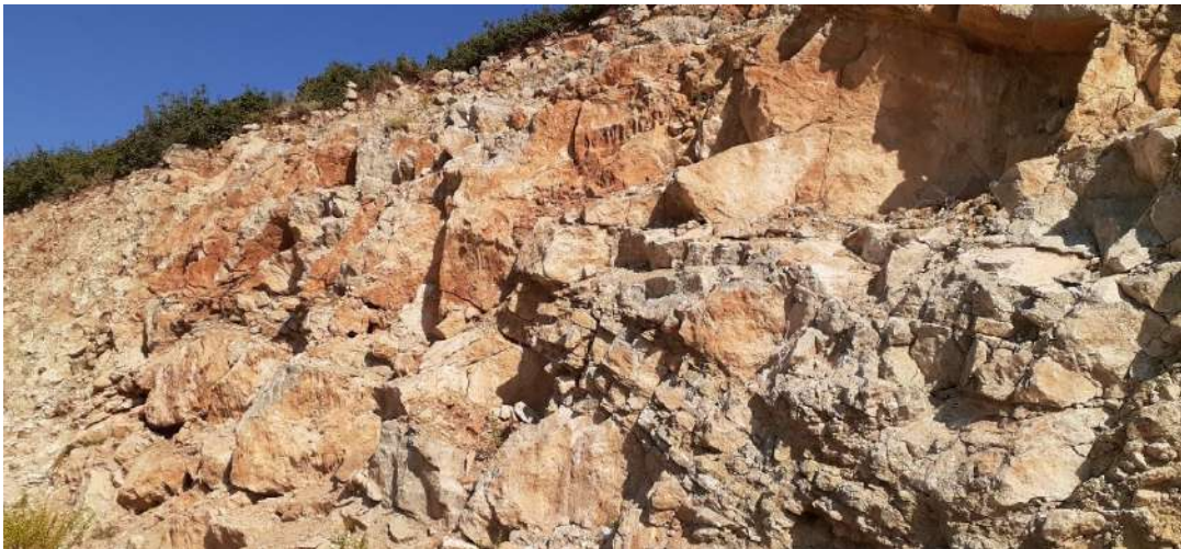
Figura 4-12 Rrëzime në ByPass Vlora km 21+975
