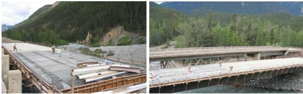
Figura 2.8. Urë prej betoni e përforcuar me FRP, Morrystown – Vermont (USA) [2002]
